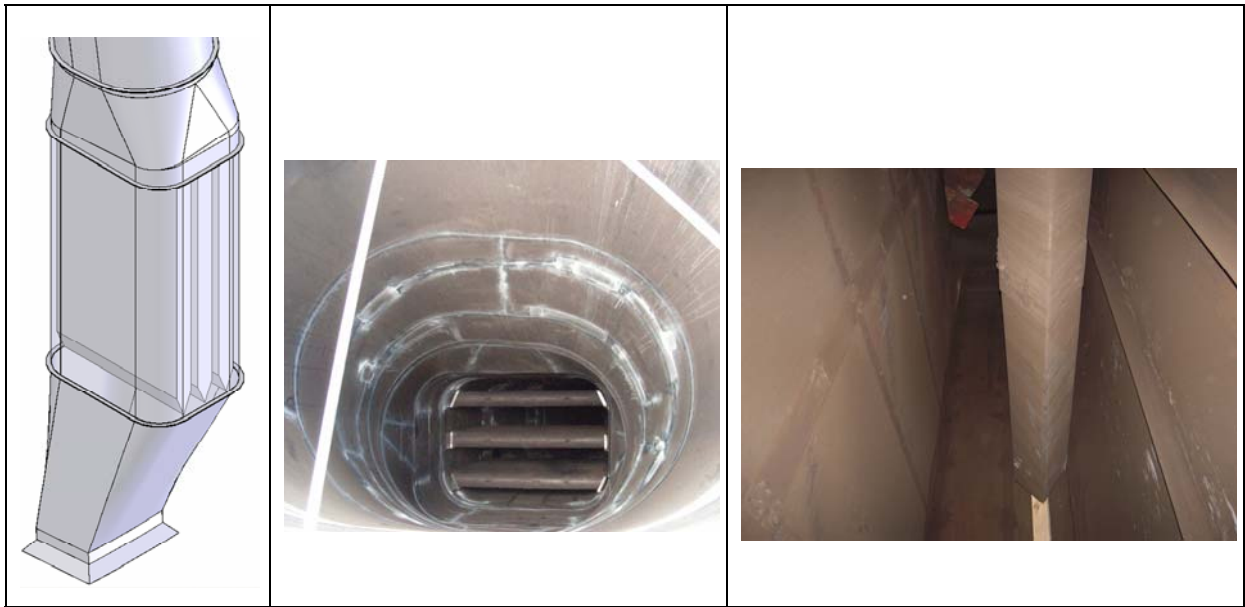
Figura 1.5 – Pormenor da conduta com os atenuadores acústicos.
