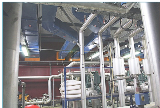
Figura VI.2 – Zona técnica - Máquinas do Sistema AVAC - Piso 1
