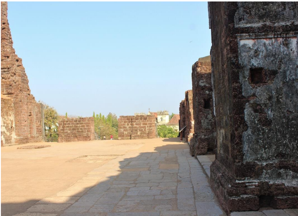
Fig. 80 - Ruínas da igreja da Nossa Senhora da Graça, Velha Goa, Índia. Orifícios entre os arcos de abertura para as capelas laterais (Janeiro de 2019)
