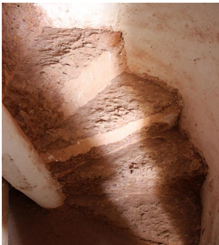
Fig. 49 - Igreja do Espírito Santo, Velha Goa, Índia. Escadas de acesso ao segundo andar de galerias (Janeiro de 2019)
