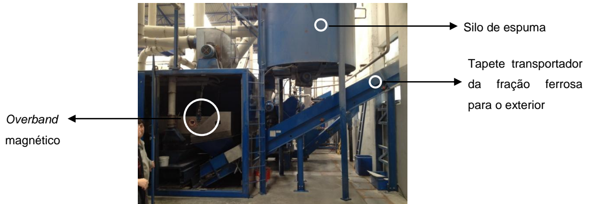
Figura 5.11 – Zona de separação e Silo de espuma
