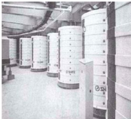
(b) TSDs instalados.
