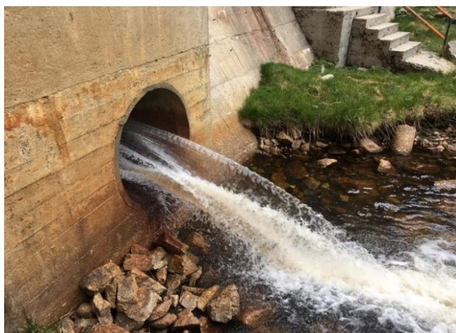
Figura 2.14 - Descarga de fundo aberta - barragem de Covão do Meio
