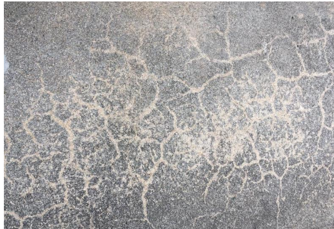
Figura 2.13 - Fendilhação no coroamento - barragem de Covão do Meio
