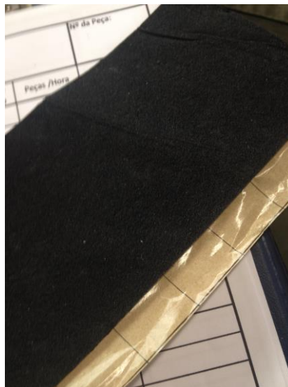
Figura 4.1 - Amostra 1 de material de revestimento dos barramentos de cobre num QEBT
