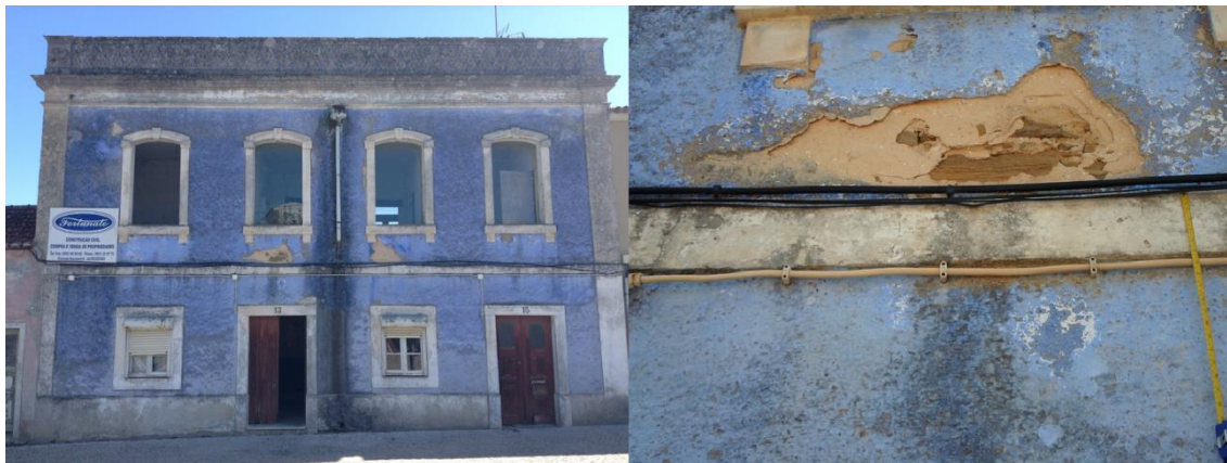
Figura 2.2 – Edifício em Alfeizerão, Alcobaça onde se denota perda de aderência.
