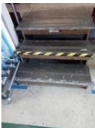
Figura 3.15. Degrau em mau estado de conservação e sem fita sinalizadora
