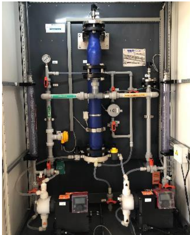
Figura 1.3 - Gerador de dióxido de cloro.
