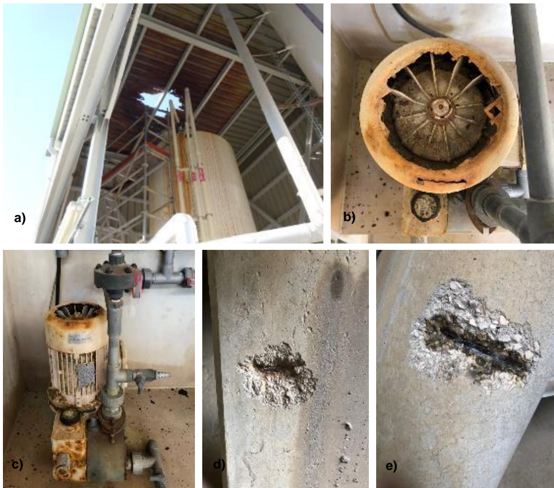
Figura 1.4 - Corrosão visível a) teto do parque de armazenamento de produtos químicos por cima do tanque de HCl; b) e c) bombas doseadoras de produtos químicos; d) e e) corrosão na estrutura da torre de arrefecimento.
