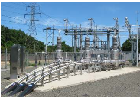
Figura 2.5 - Sistema de cabos SAT de 138 kV instalado em Nova York, EUA. Retirado de http://www.conectus.org/technology.html [02/09/14].
