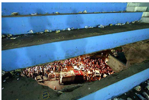
(b) Vista superior da bancada colapsada [2]
