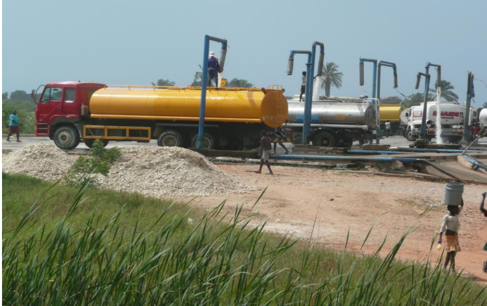
Figura 6. Sistema de captação de água no rio Bengo, área do Cacucaco. (original de J. F.)
