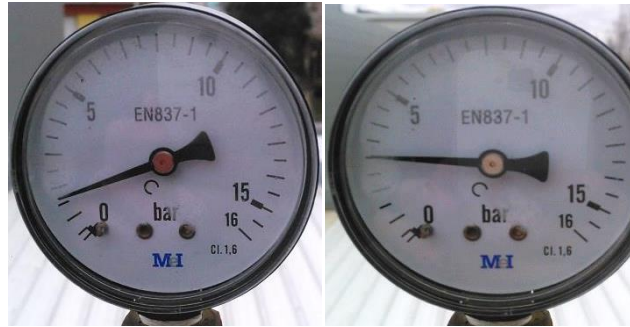
Figura 3.12 - Manómetro da bomba do circuito primário do chiller novo e pressão a jusante e a montante da mesma
