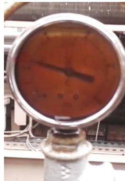
Figura 3.13 - Manómetro de pressão da bomba do circuito primário do chiller mais antigo
