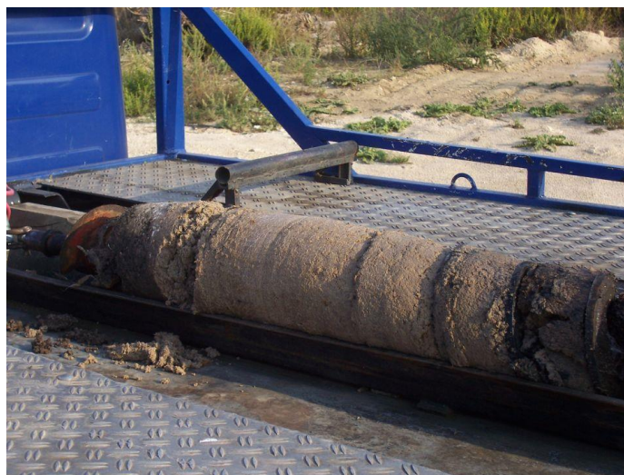
Figura 5.6 – Sólidos acumulados no parafuso sem-fim (zona de elevação)
