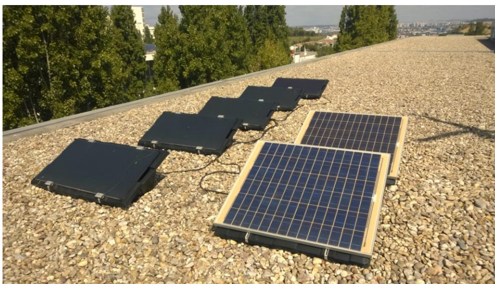
Figura 3.8 - Instalação fotovoltaica instalada no topo do edifício do DEE
