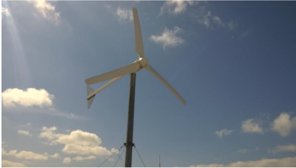
Figura 3.7 - Gerador eólico instalado no topo do edifício do DEE
