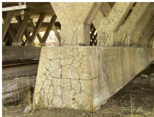
Figura 9 - Pilar de viaduto sujeito a reações expansivas (Thomas, Fournier e Folliard 2013).
