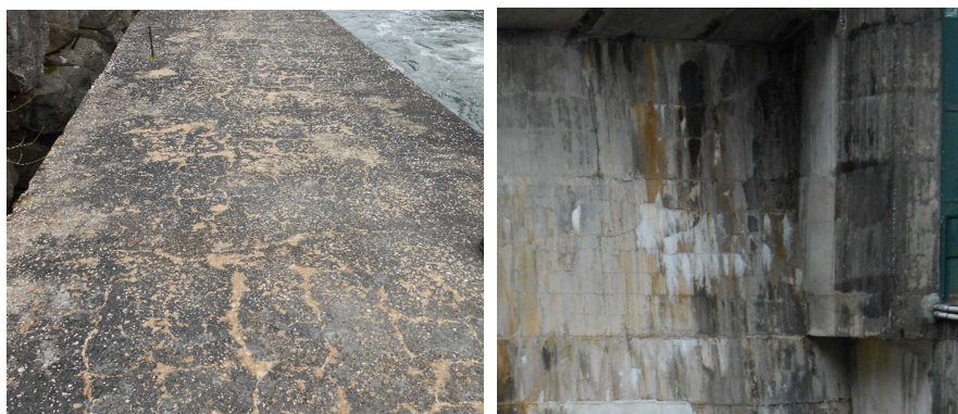
Figura 14 - Fissuração devida a RAA em contraforte (à esquerda) e no paramento de jusante da abóbada direita da barragem de Fagilde (à direita).
