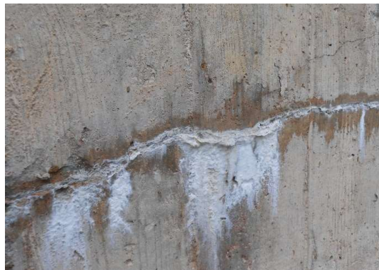
Figura 15 - Pormenor das exsudações e eflorescências numa das fendas do paramento de jusante da abóbada esquerda da barragem de Fagilde
