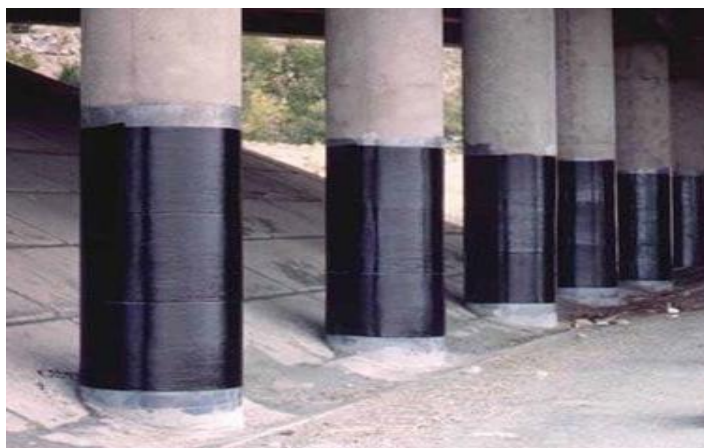
Figura 1.3 – Aspeto de pilares reforçados por aplicação de encamisamento com coletes de CFRP
