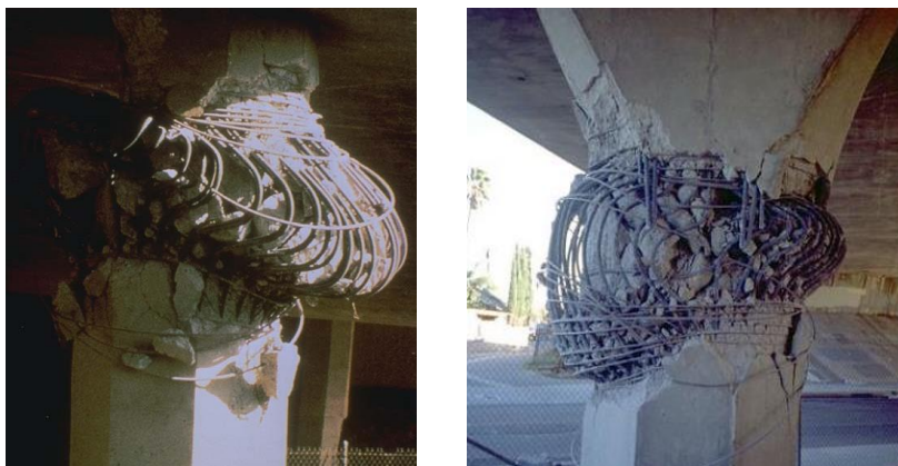
Figura 1.1 – Colapso de pilares verificada na autoestrada de Santa Monica durante o sismo de Northridge em 1994
