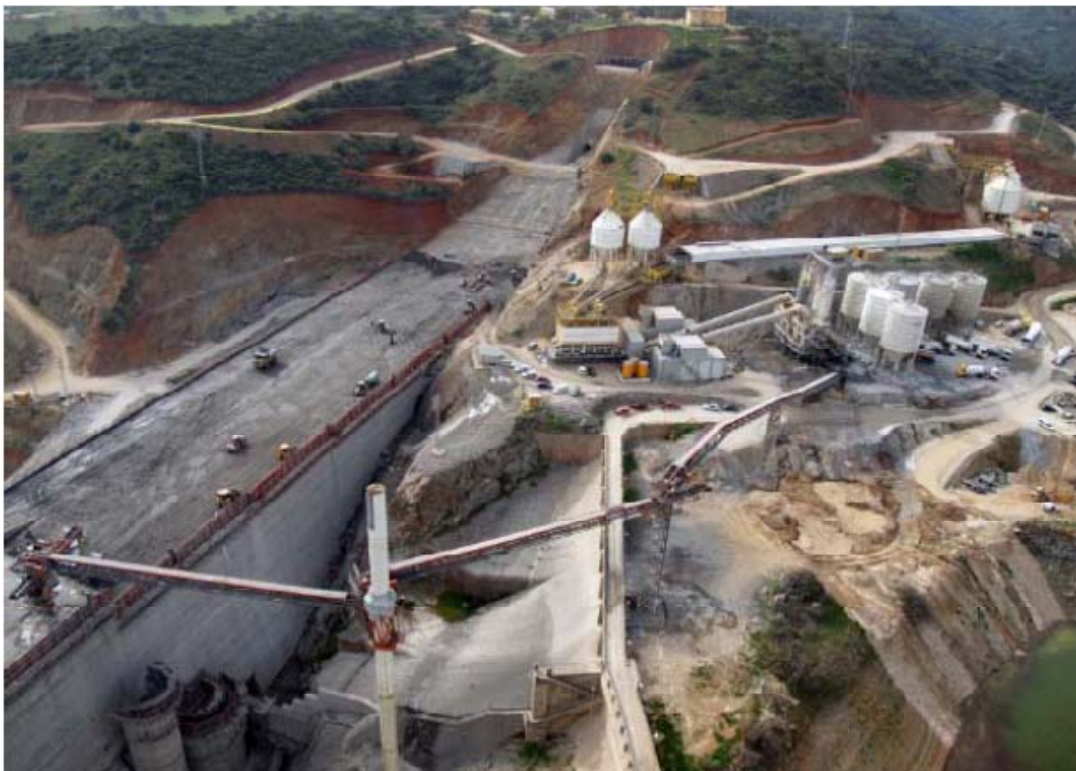
Figura 3.8 – Transporte da mistura através de tapetes rolantes na barragem de Berña Espanha (Sagrado, 2008).
