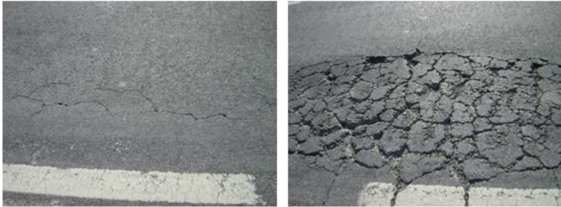
Figura 5.51 – Fendilhamento de gravidade 2 (à esquerda) e fendilhamento de gravidade 3 (à direita)
