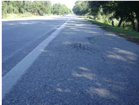
Figura 5.50 – Empolamento causado pelas raízes das árvores
