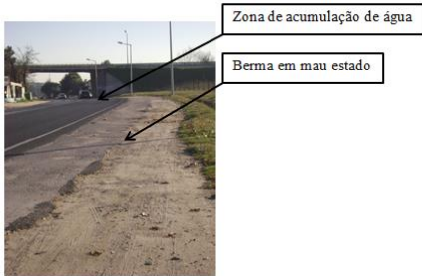
Figura 5.37 – Zona de acumulação de água e bermas em mau estado
