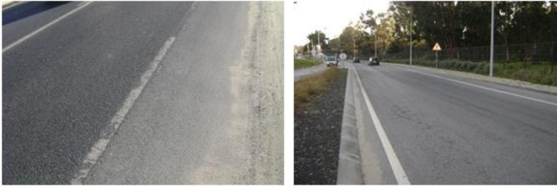
Figura 5.39 – Bermas revestidas (à esquerda) e reparações (à direita)
