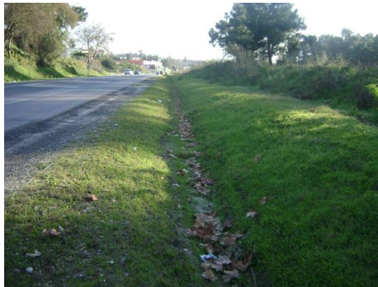
Figura 5.40 – Valetas não revestidas
