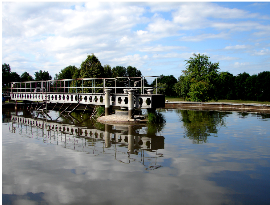
Figura 4.1 – Fotografia de um decantador primário da ETAR de Horstermeer
