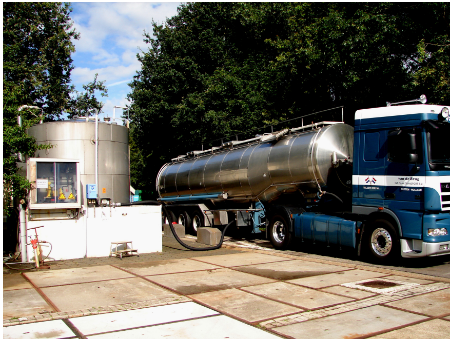
Figura 4.2 - Fotografia do ponto de descarga e armazenamento de resíduos industriais especiais na ETAR de Horstermeer
