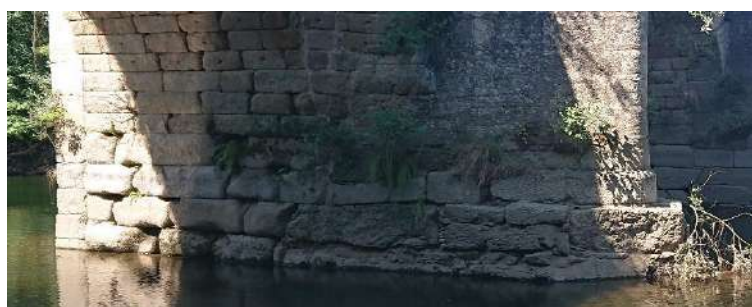
Figura 6.17 - Erosão juntas do Pilar P3, lado Este
