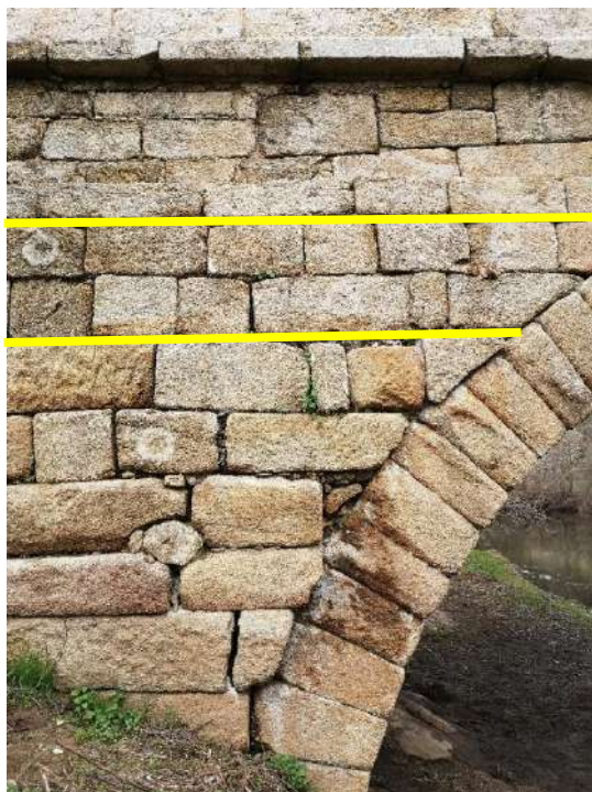
Figura 6.57 - "Embarrigamento" muro de tímpano Sul, Encontro Oeste
