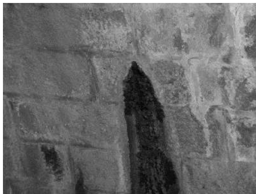
Figura 3.8 - Dreno localizado ao nível do arco (Lopes, 2012)
