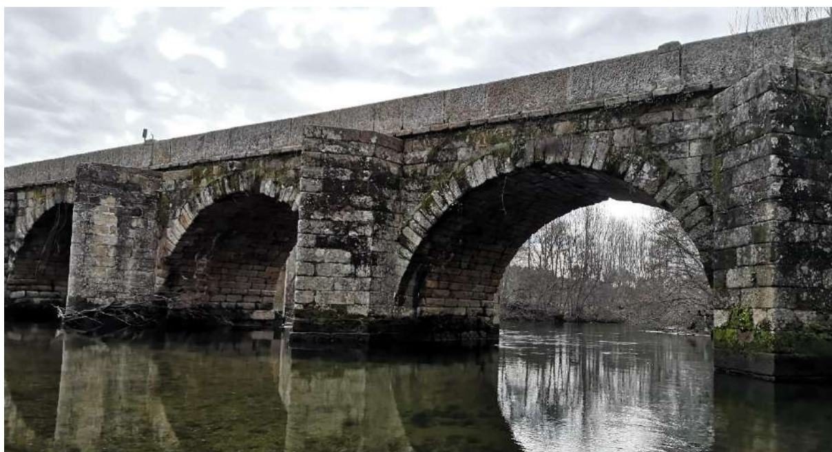
Figura 6.11 - Vista de três arcos consecutivos; A2, A3 e A4; Alçado Norte; Encontro Oeste
