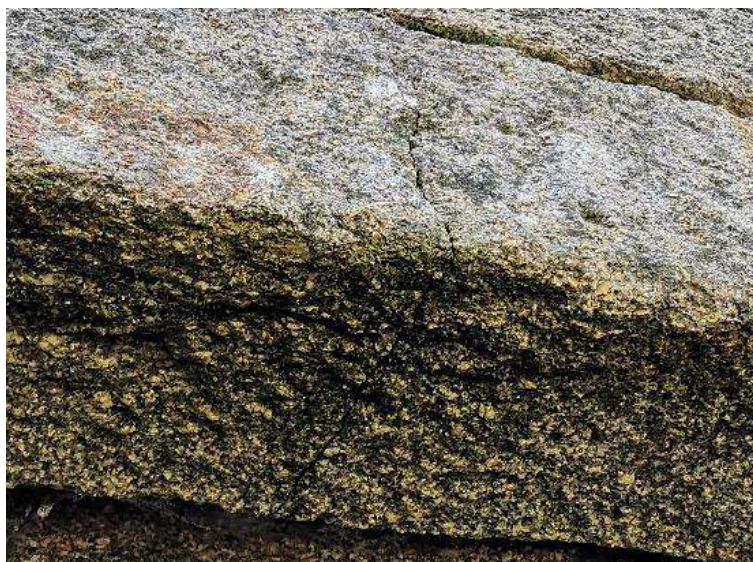
Figura 6.22 - Lajeta fissurada na primeira secção de vazão, Alçado Norte, Encontro Oeste
