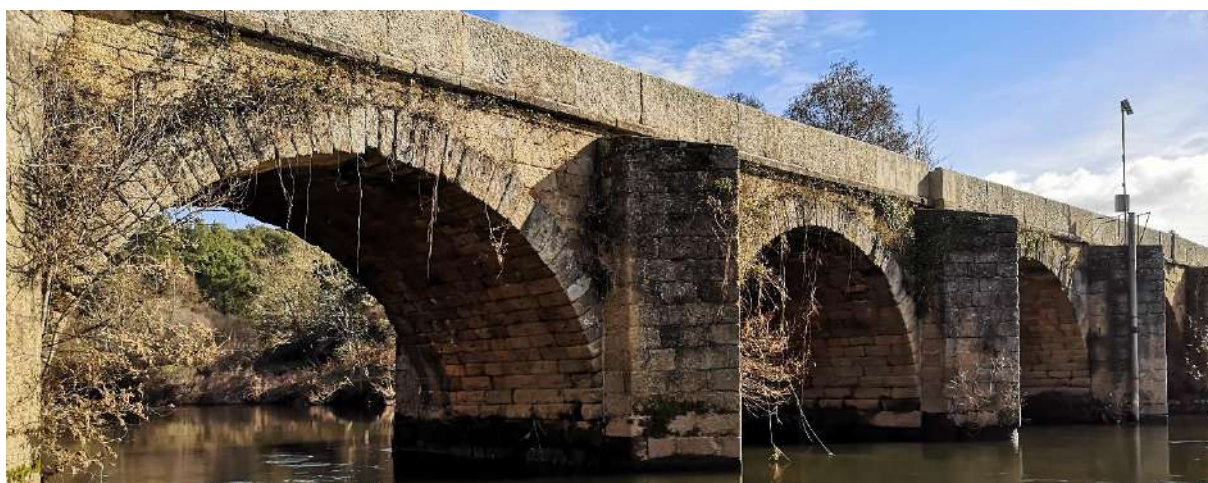
Figura 6.5 – Estrutura após ser desmatada; A1, A2 e A3; Alçado Sul, Encontro Oeste
