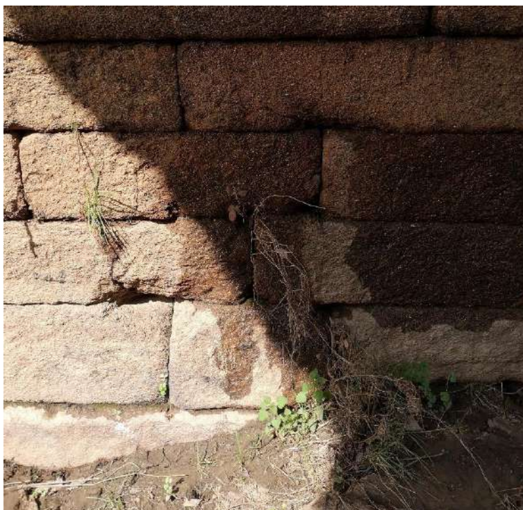
Figura 6.26 - Infiltração de água no arco A1
