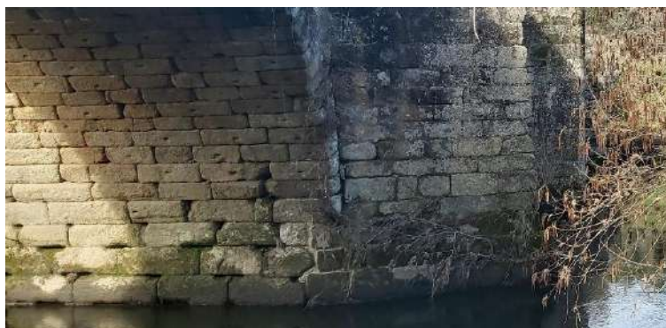
Figura 6.16 - Erosão das juntas do Pilar P4, lado Este
