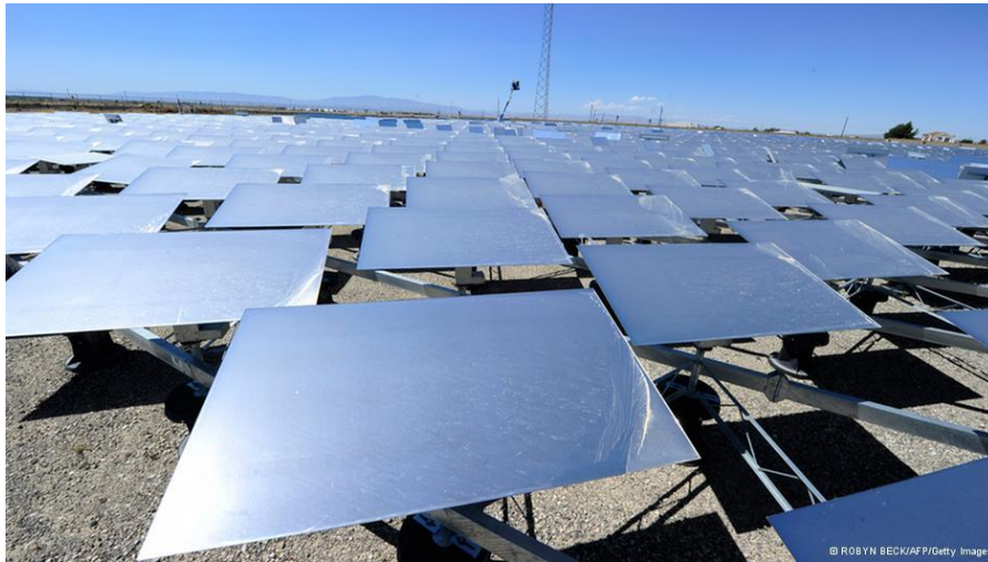
Figura 4. Painéis fotovoltaicos em solo nos EUA. Fonte: Can Stock Photo
