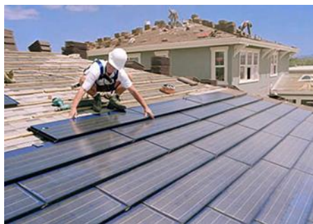
Figura 12. Painéis Solares de dupla função
