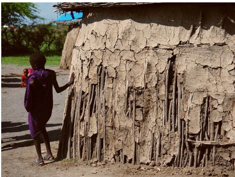
Figura 3 – Habitação Massai a necessitar de reparação da argamassa de terra de preenchimento e revestimento, colocando em risco a estrutura (no caso em troncos). Tanzânia.
