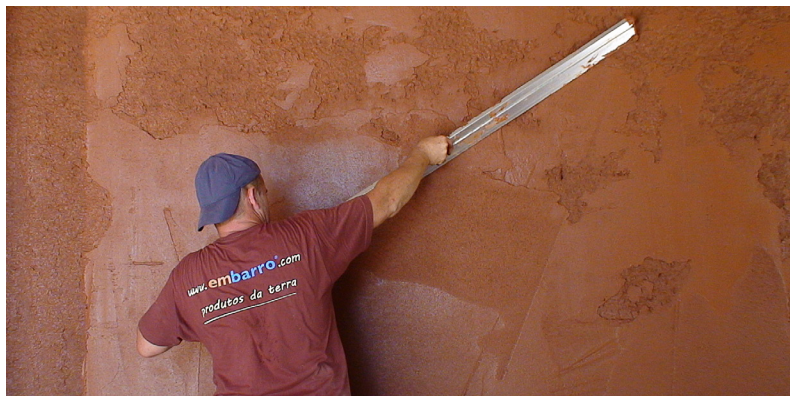
Figura 44 – Regularização da camada de reboco de argamassa de terra pré-doseada com recurso a régua. Execução: EMBARRO, com reboco “Embarro Universal”.
