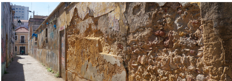
Figura 6 – Parede com necessidade de encasque de regularização para ser de novo rebocada. Setúbal.
