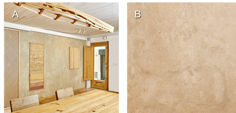
Figura 37 – Reboco de terra, estabilizado com cal aérea e fibras de trigo, em obra de reabilitação. Arquitectura: Alina Jerónimo e Paulo Carneiro (CAS-STUDIO). Crédito: José Costa.
