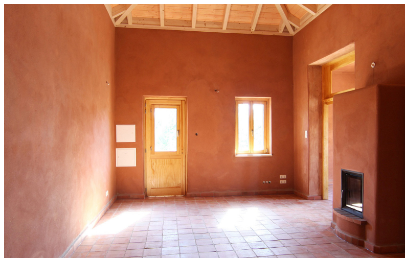
Figura 51 – Sala em obra de reabilitação, com paramentos interiores revestidos com argamassa de reboco de terra pré-doseada e acabamento “à vista”, afagado com talocha de madeira. Tavira. Arquitectura: Paola Boragine. Execução e crédito: Joachim Reinecke (EMBARRO, com reboco “Embarro Universal”).
