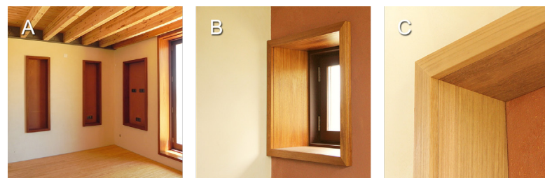
Figura 76 – Protecção de ombreiras, vergas e peitoris interiores com elementos de madeira. Arquitectura: José Lima (OFICINA INTEGRADA). (A) Vista geral de um compartimento. (B) Pormenor de vão exterior. (C) Pormenor de nicho em parede.
