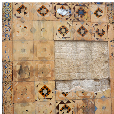
Figura 7 – Reboco de regularização e colagem, à vista em lacuna de revestimento com azulejos. Setúbal.
