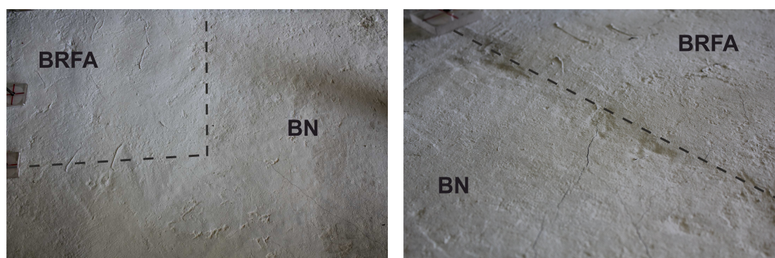
Figura 4.41: Primeiras fendas visíveis na interface dos betões dos modelos, sendo com menor abertura no BRFA do que betão normal sem fibras.
