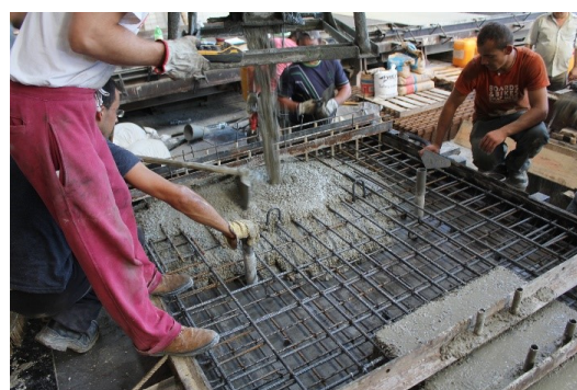
(b) Colocação do restante betão, neste caso normal sem fibras, no perímetro exterior.
