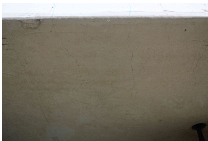
Figura 6.59: Fendas na face inferior do modelo F0.75_4D, junto ao bordo Norte, no ciclo de 3.5% de drift .
