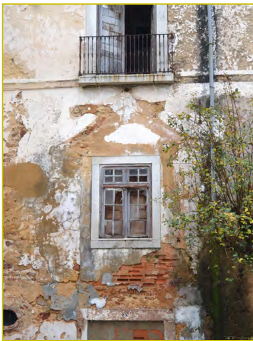
Figura 3 Pormenor das marcas decorrentes da justaposição do volume demolido que se observa na Figura 2, à esquerda, onde se nota a marcação no reboco das duas pendentes do telhado sobre a janela. Fotografia da autora.
