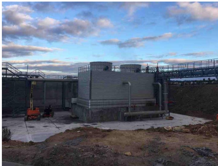
Fig. 4.16- Torres de arrefecimento.
