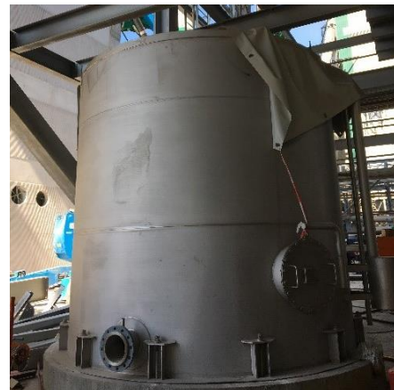
Fig. 4.9- Tanque de Mistura.
