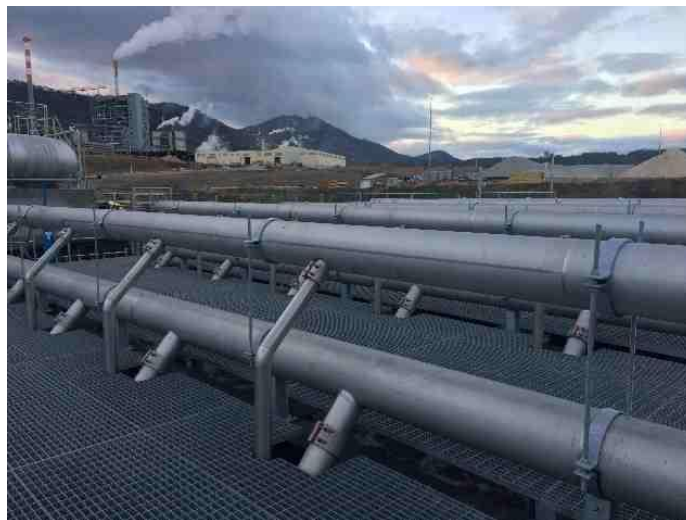
Fig. 4.19- Tanque de membranas de ultrafiltração
