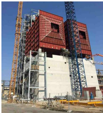
Fig. 4.10- Eletrofiltros (sem revestimento).
