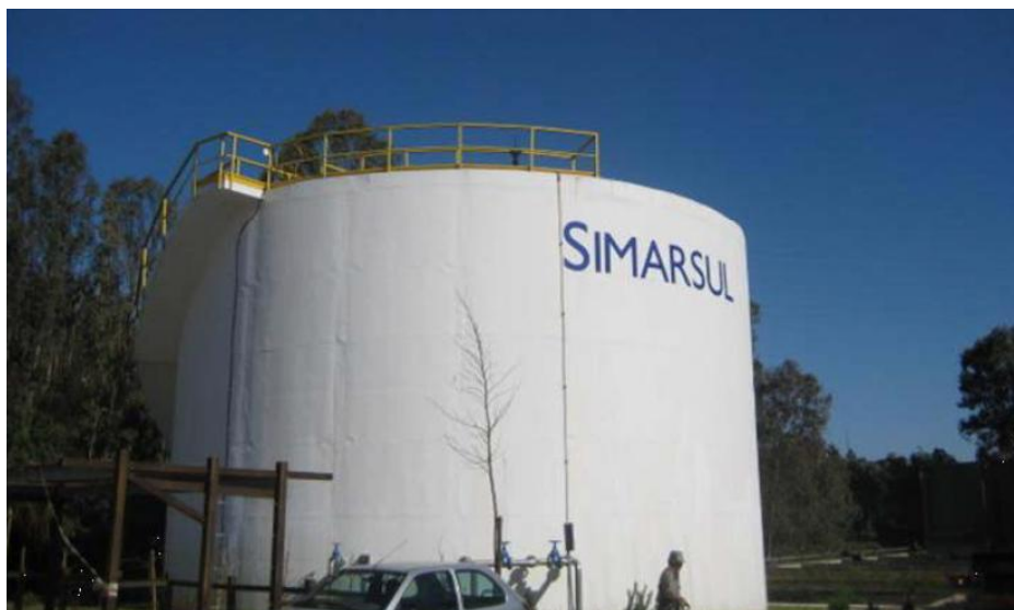
Figura 1. 1 – Digestor anaeróbio de uma ETAR gerida pela SIMARSUL (fotografia gentilmente cedida por Nuno Lapa, 2010)
