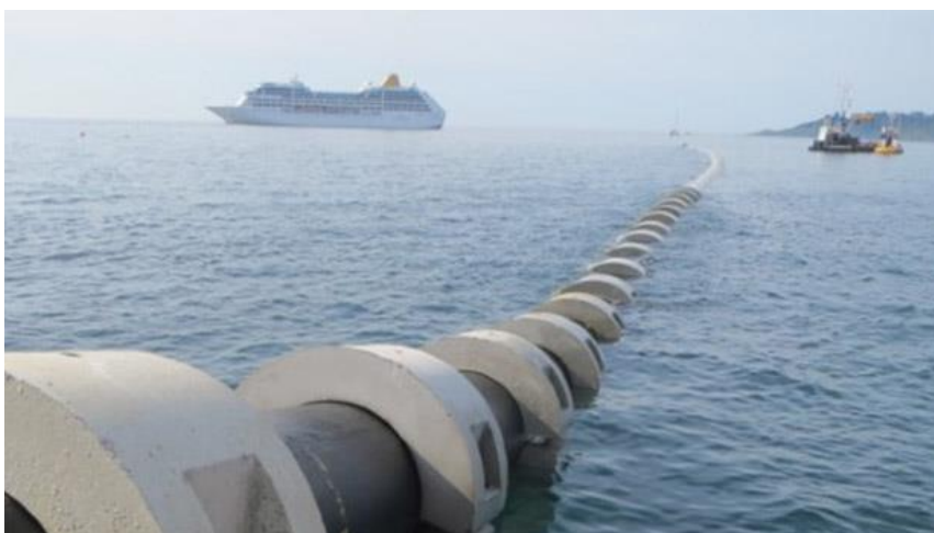
Figura 2.1 – Exemplo de colocação de um emissário submarino com anéis de afundamento ( www.royalhaskoningdhv.com )
