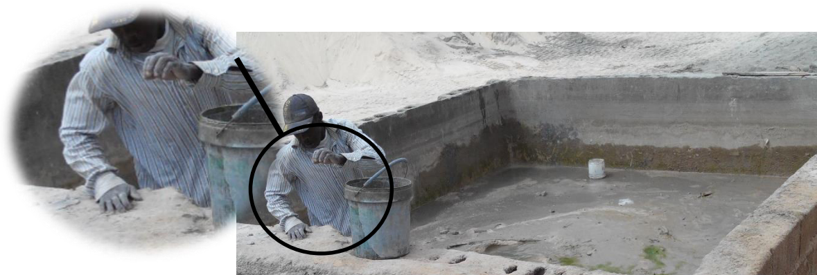
Figura 6.12 - Trabalhador sem luvas (contacto com cimento)
