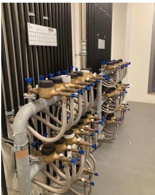
Figura 4.12 – Baterias de contadores de um lote.
