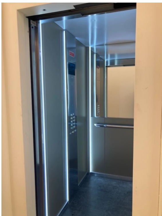
Figura 4.16 – Interior de um dos elevadores.
