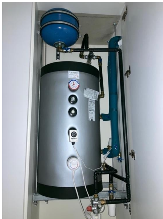
Figura 4.14 – Termoacumulador no interior de uma fração.
