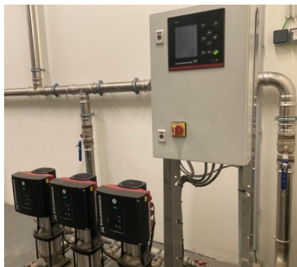
Figura 4.13 – Bombas circuladoras e quadro elétrico.
