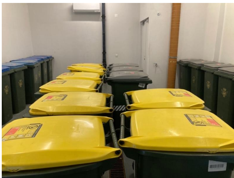
Figura 4.18 – Sala técnica de resíduos.
