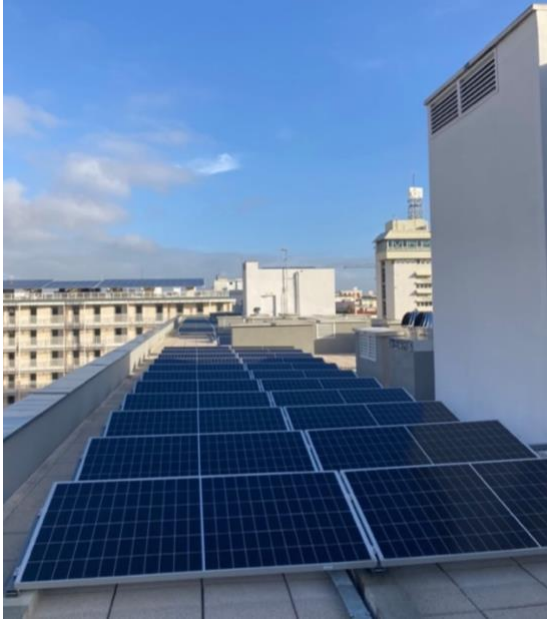
Figura 4.5 – Sistema fotovoltaico do edifício.
