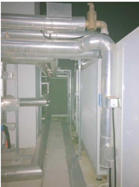
Figura 4.7 – Sistema de bombas de calor.
