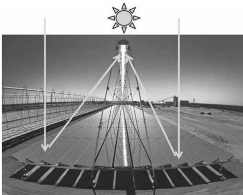
Figura 8 - Central Kimberlina LFR, Bakersfield California, cortesia de AREVA Solar [48].
