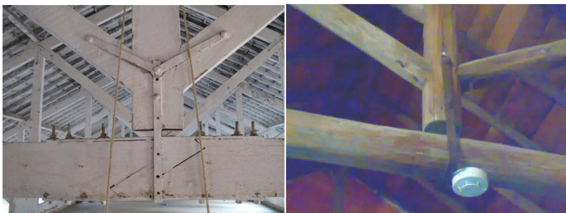
Figura 5.1 – Ligação pendural – linha com recurso a um pé de galinha (esquerda – a) e com recurso apenas a uma braçadeira (direita – b)
