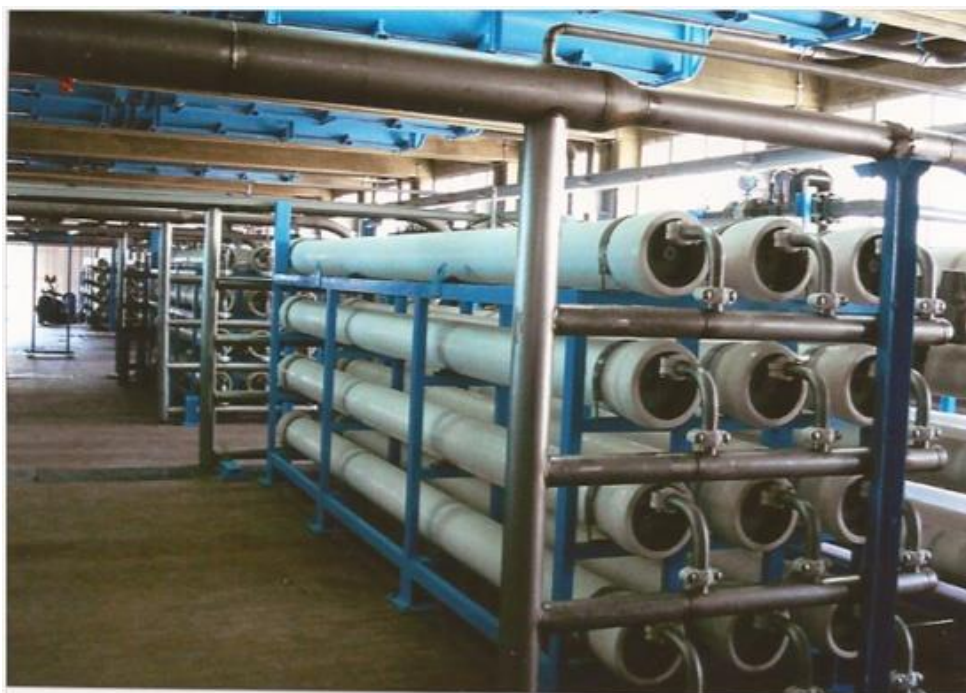
Figura 19 - Unidades de osmose inversa (IGA, 2015)
