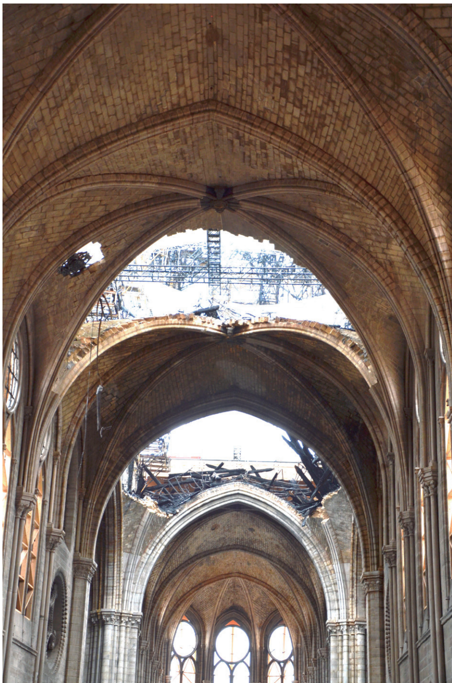
Fig. 2 – Vue de l'intérieur de Notre-Dame de Paris après l'incendie. Trous dans les voûtes de la nef et de la croisée.
