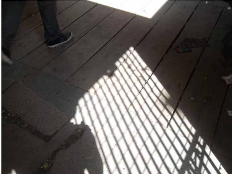
Figura 4.10 - Piso da interface irregular e inadequado. Fonte: Próprio
