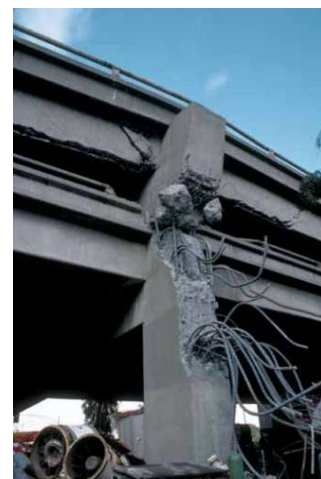
(b) Pormenor da falha nos pilares
