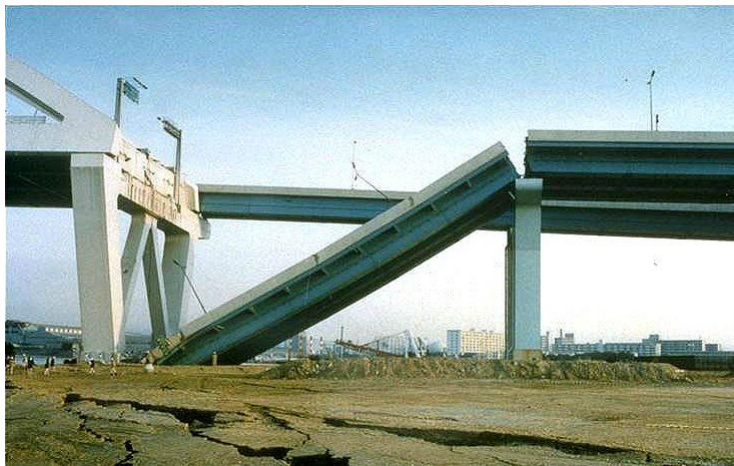
Figura 2.3: Queda do tabuleiro da ponte Nishinomiya em Kobe, Japão, [24]
