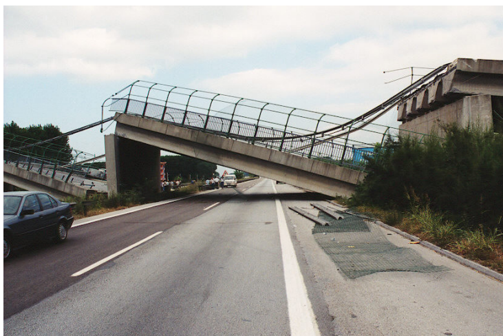
Figura 2.4: Queda do tabuleiro devido à incapacidade de acomodar deslocamentos Izmit, Turquia, [24]
