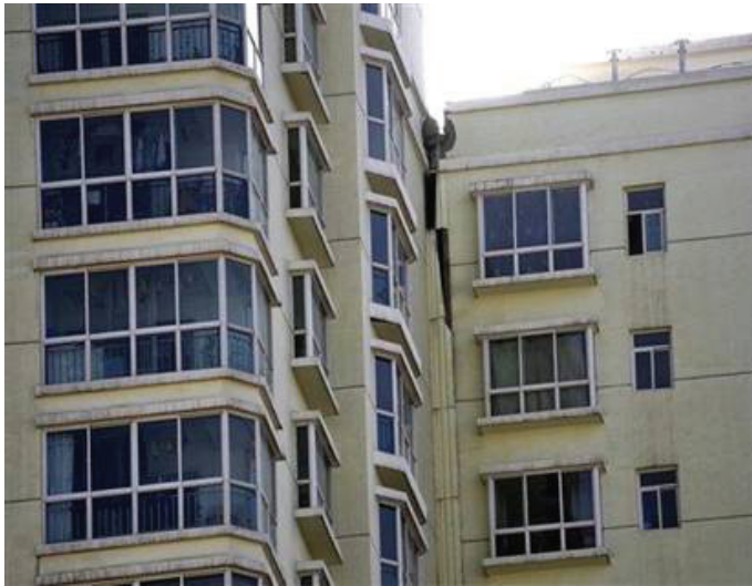
Figura 11.5 Danos num canto reentrante após um sismo de magnitude de 7.8 que assolou Lanzhou na China em 2008. [FONTE: AP Photo / CHINA OUT]
