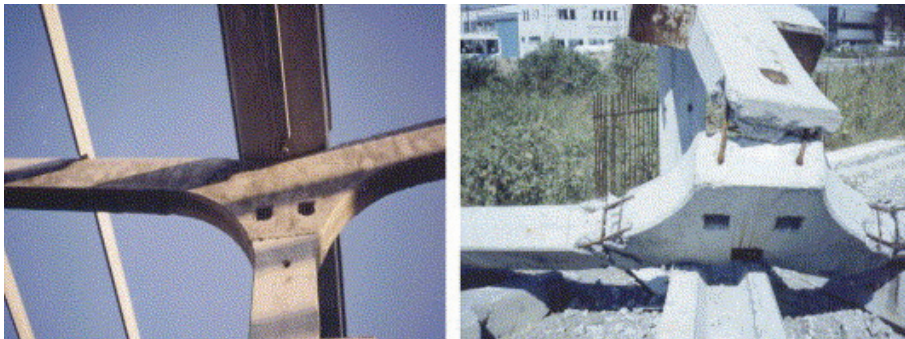
Figura 11.22 Colapso do pilar central em portico de vão duplo (sem danos na foto da esquerda, após o colapso na foto da direita). Sismo de agosto de 1999 em Adapazarı na Turquia [3].
