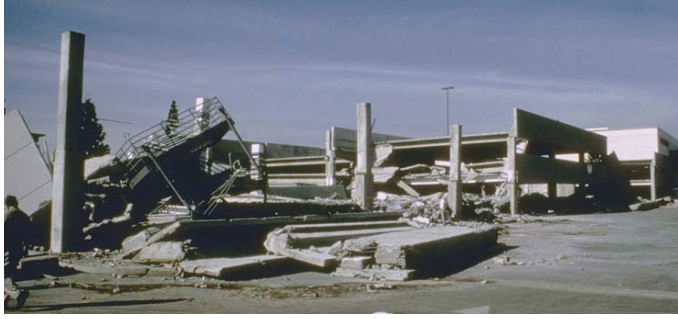
Figura 11.20 Danos na estrutura do parque de estacionamento do Northridge Fashion Center (1994), sismos de San Fernando Valley, 1971, 1994
