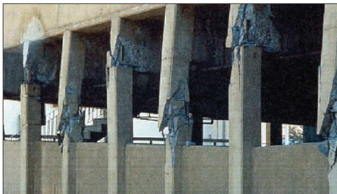
Figura 11.15 Estrutura do parque de estacionamento danificada no sismo de Whittier Narrows (Los Angeles), 1987. Vigas de fachada altas criando uma situação de viga-forte, pilar-fraco. [fonte: NISEE]
