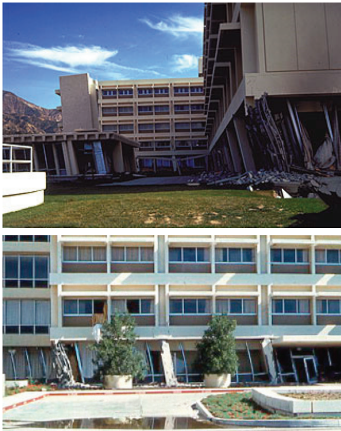
Figura 11.14 Hospital Olive View, sismo de San Fernando, 1971, mostrando a deformação excessiva dos pilares acima do nível do solo [fonte: NISEE]
