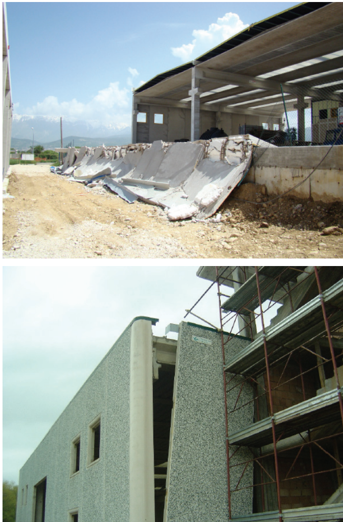
Figura 11.27 Colapso para fora do plano dos painéis de revestimento durante o sismo de L'Aquila, 2009 [4].
