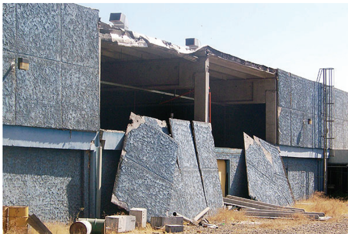
Figura 11.26 Colapso de painéis de fachada durante o sismo de Santiago do Chile, 2010
