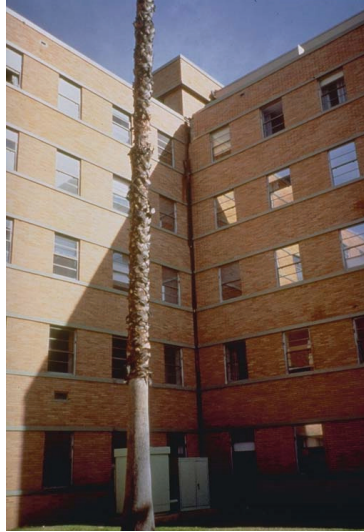
Figura 11.6 Danos observados no edifício do Hospital de Sepulveda, depois de um sismo de magnitude 6.8 que ocorreu em Vale de São Fernando (Los Angeles, EUA).
