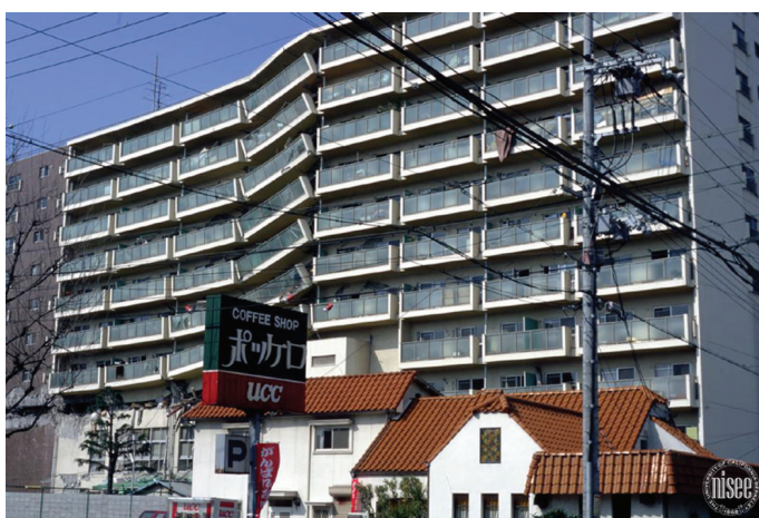
Figura 11.13 Sismo de Kobe, 1995, colapso parcial de edifício de apartamentos [fonte: NISEE]
