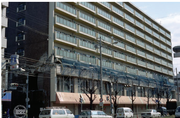
Figura 11.12 Sismo de Kobe, 1995, edifício mostrando o colapso total do 3º piso [fonte: NISEE]
