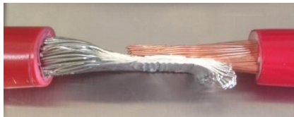
Figura 2.6-Esmagamento dos cabos devido a excesso de pressão e/ou energia
