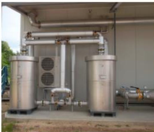
Kläranlage Wolfsburg 2 x 0,7 m 3 / Außenaufstellung isoliert Abscheidung von Siloxanen und H 2 S
