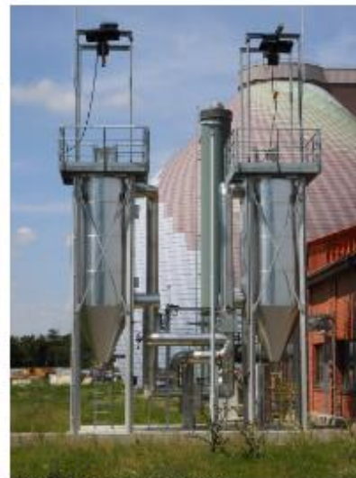
Kläranlage Magdeburg-Gerwisch 2 x 7 m 3 / Außenaufstellung isoliert Abscheidung von Siloxanen und H 2 S
