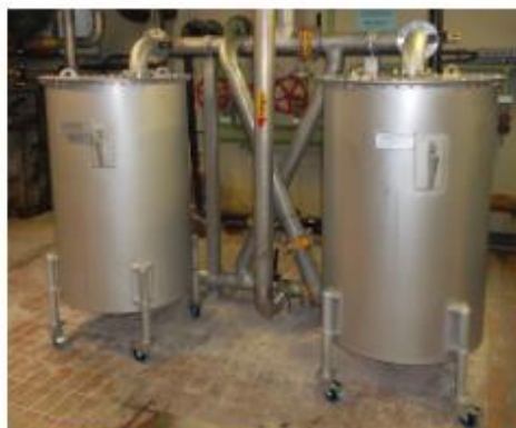
Kläranlage Werne (Lippeverband) 2 x 0,7 m 3 als Kartuschensystem / Aufstellung innen Abscheidung von Siloxanen und H 2 S
