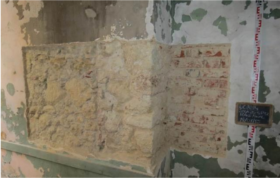
Fig. 20 – Exemplo de uma sondagem parietal realizada no Palácio Conde Barão de Alvito. Sondagem parietal 12, 2.º piso, regista o fecho do antigo acesso (Fonte: Relatório Preliminar de trabalhos arqueológicos, Neoépica)
