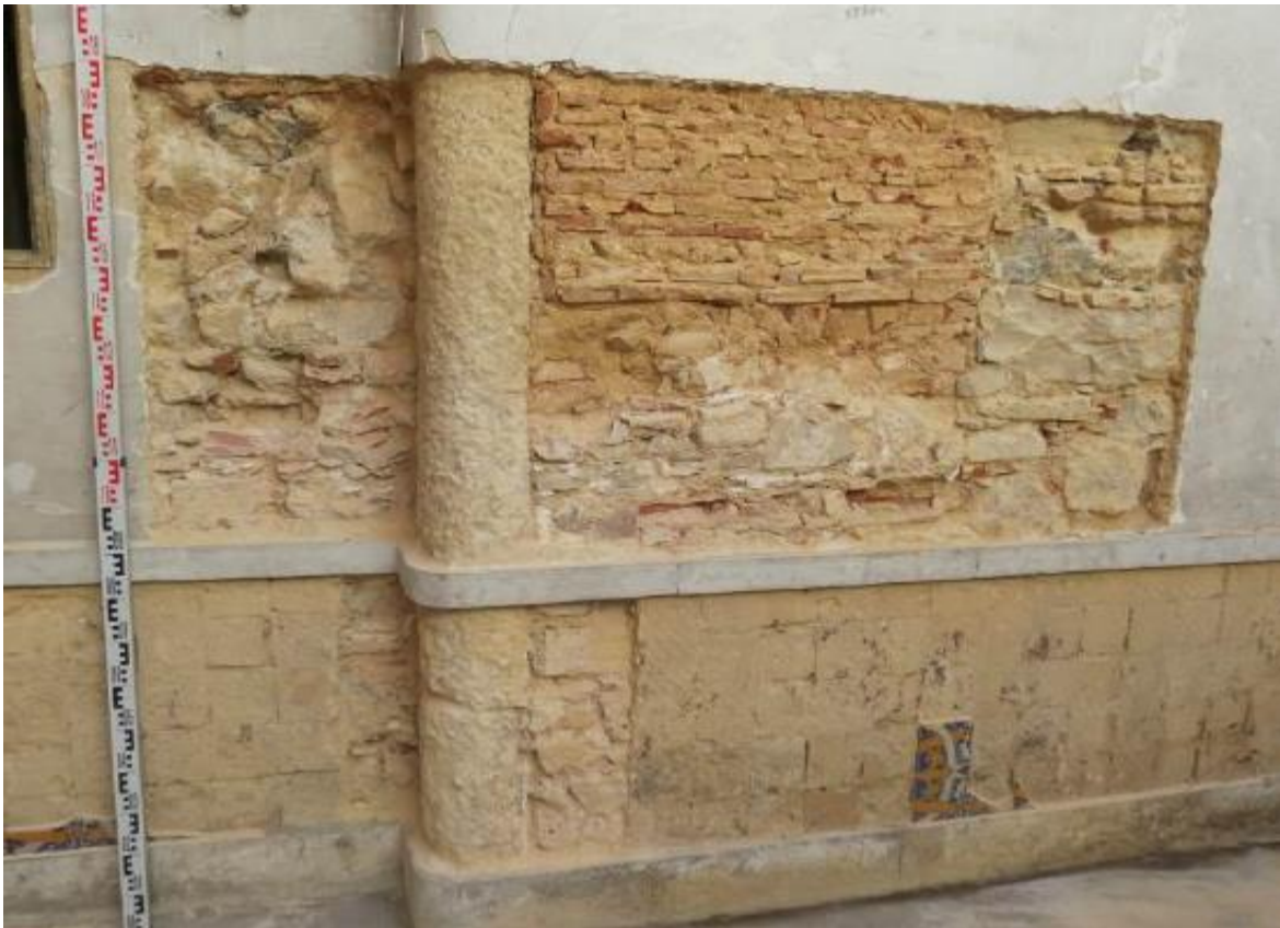
Fig. 21 – Exemplo de uma sondagem parietal realizada no Palácio Conde Barão de Alvito. Sondagem parietal 32, 1.º piso, ilustra o fecho do acesso pelo lado Oeste aos pisos superiores (Fonte: Relatório Preliminar de trabalhos arqueológicos, Neoépica)
