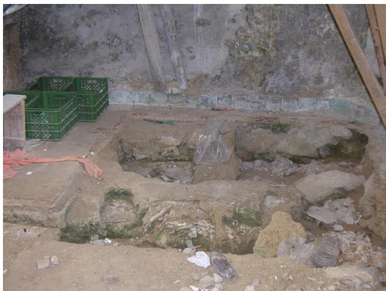
Fotografia nº 104 – Estado de abandono do interior da Igreja em 2005. Igreja de São Lourenço, Lisboa. Fonte: Sabrosa, 2005.
