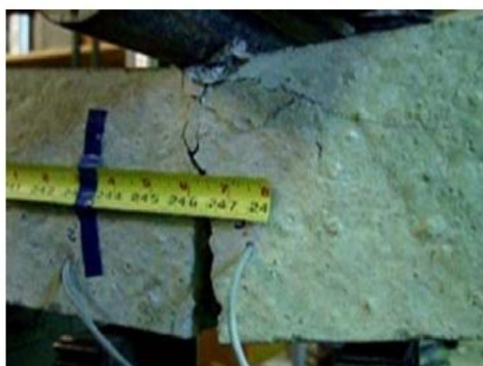
(a) Aparecimento de fenda devido ao carregamento
