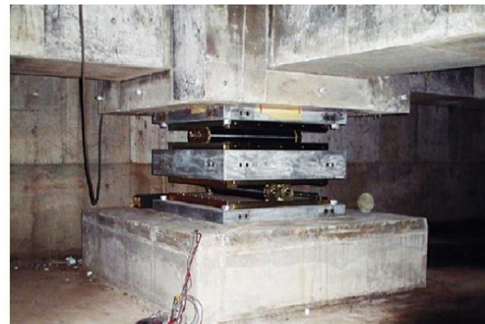
(b) Isolamento de base instalado num edifício no Japão
