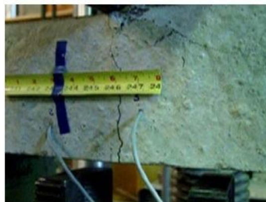
(b) Fecho da fenda devido à força elástica originada pelos cabos de LMF após descarga da viga
