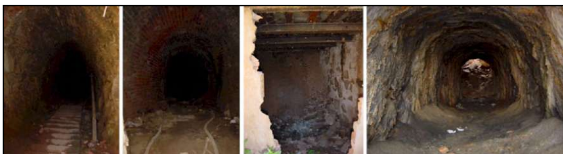
Fig. 5.15 – Galerias subterrâneas de acesso a mina e à direita túnel do caminho-de-ferro, entulhado devido a derrocada.
