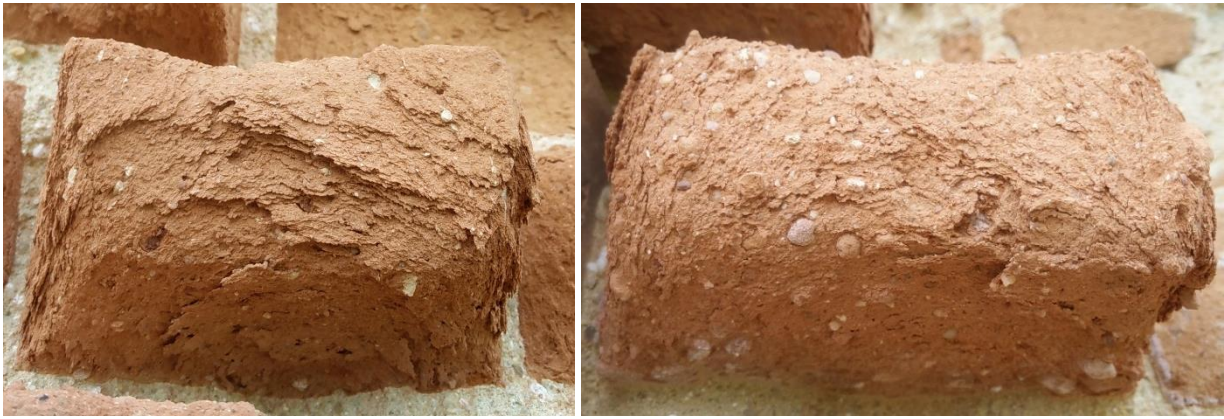
Figura 4.5 - Tijolos em avançado estado de degradação. Erosão avançada.
