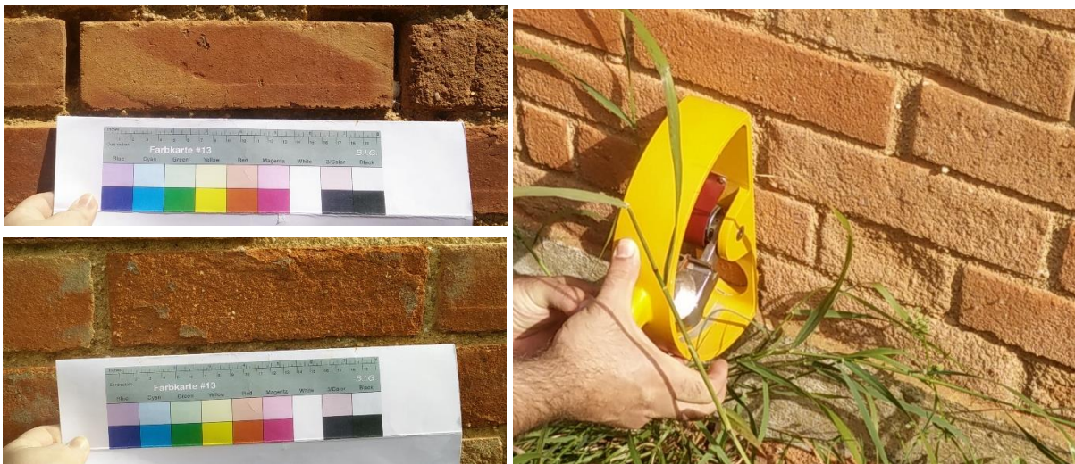
Figura 4.9 - Tijolos com diferentes estados de conservação (à esquerda) e ensaio com esclerómetro pendular (à direita).
