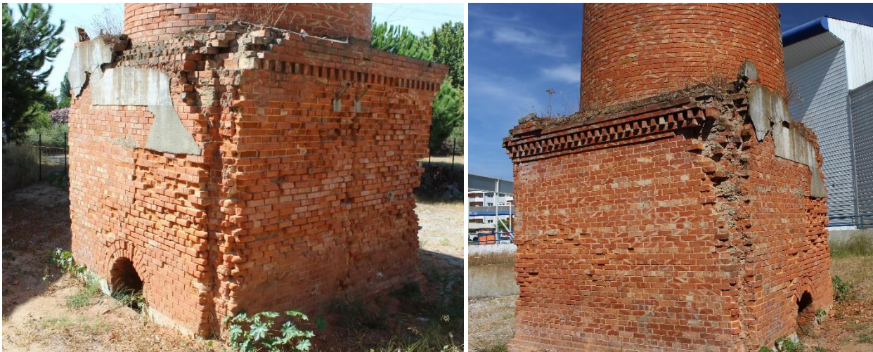
Figura 4.4 - Falta de material na base da chaminé.
