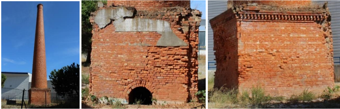
Figura 4.2 - Vista geral da chaminé (à esquerda) e vista geral da base da chaminé (ao centro e à direita).
