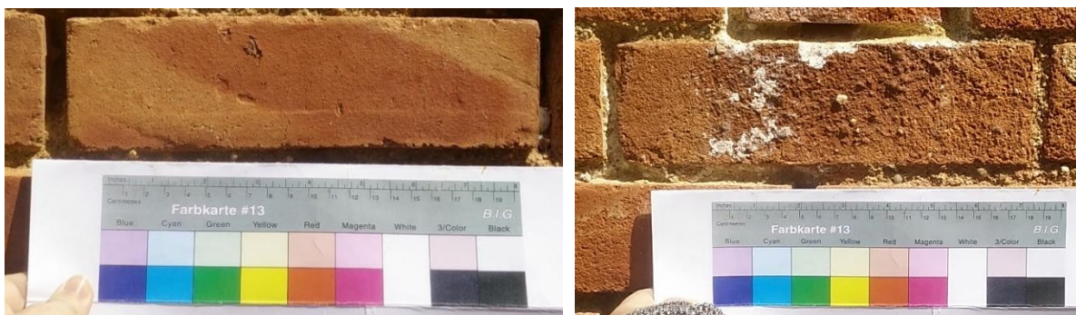
Figura 4.21 - Tijolo em bom estado de conservação (à esquerda) e tijolo em mau estado de conservação (à direita).
