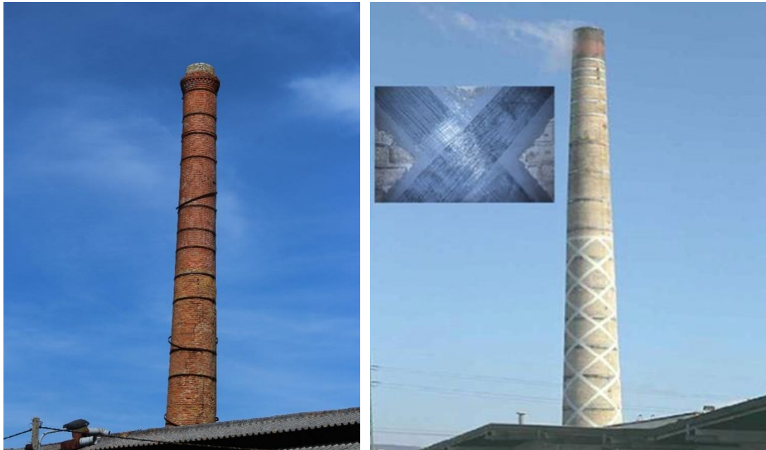
Figura 2.14 - Chaminé com cintas metálicas (à esquerda) e chaminé com cintas de FRP (à direita-SIKA Company Catalogue citado por Pallarés et al. 2011).
