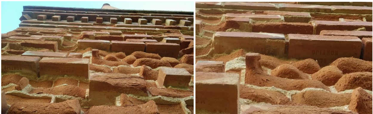
Figura 4.6 - Diversidade do estado de conservação dos tijolos.
