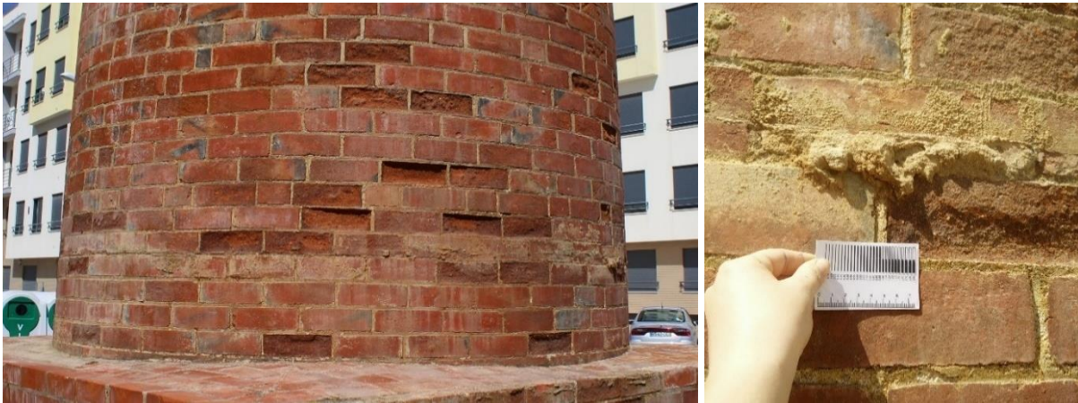
Figura 4.8 - Erosão de alguns tijolos do fuste (à esquerda) e eflorescências no material (à direita).
