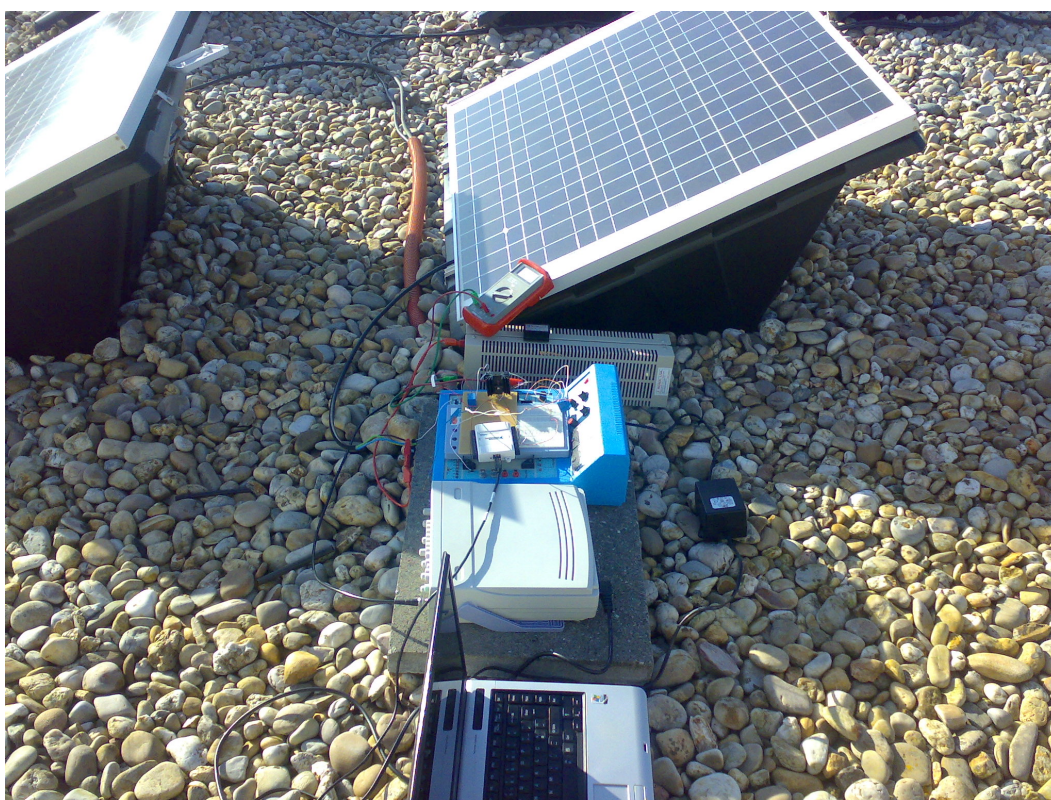
Figura 4.40: Sistema instalado no telhado do edifício X
