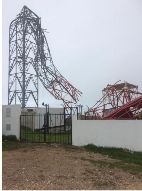
Figura 32 - Torre de rádio do farol do Cabo da Roca destruída pelo vento forte em dezembro de 2017 (Foto original, 2017)
