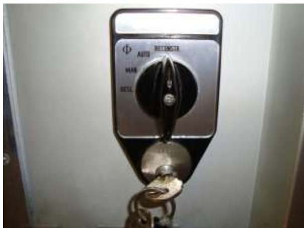
Figura 3.30 – Comutador do alimentador em “Reconstrução”
