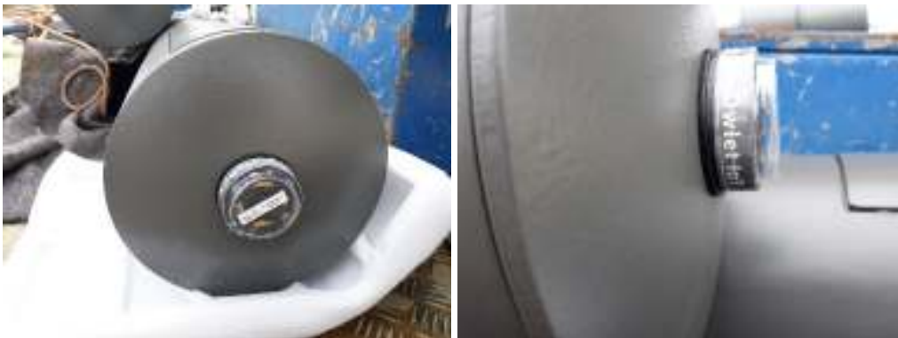
Foto 13 – Controlador OWLET de luminária no topo da luminária
