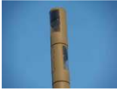
Foto 14 - Exemplo de conjunto de 2 luminárias
