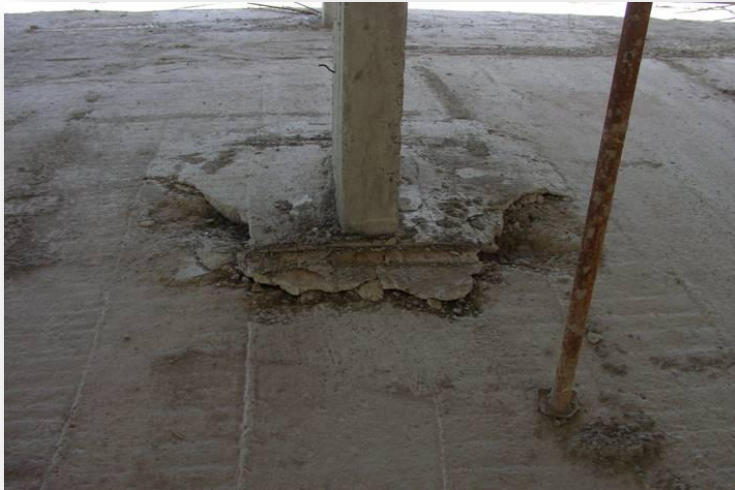
Rotura por punçoamento
